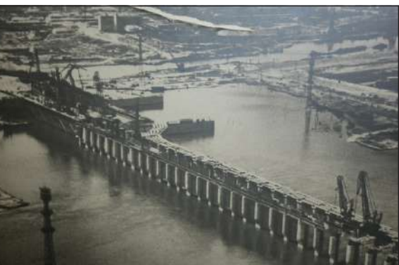
Будівництво Каховської ГЕС (розпочалося у вересні 1950 р., перший агрегат запрацював у 1956 р.)
